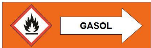
Rörledningsmärkning med faropiktogram
