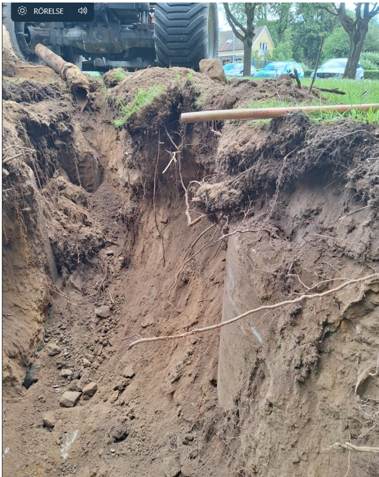
Figur 12 FH2405 Rester av cement- och gjutjärnsrör.
