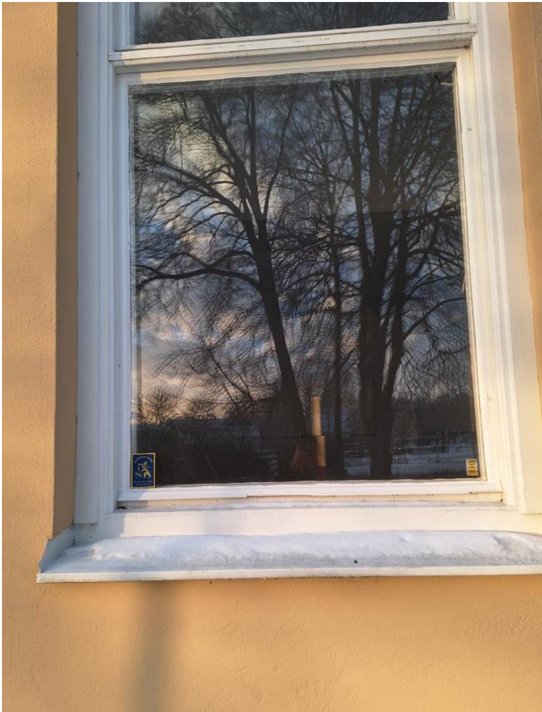
Figur 13 Fönster med träkarm. Inga mjukfogar kan ses.
