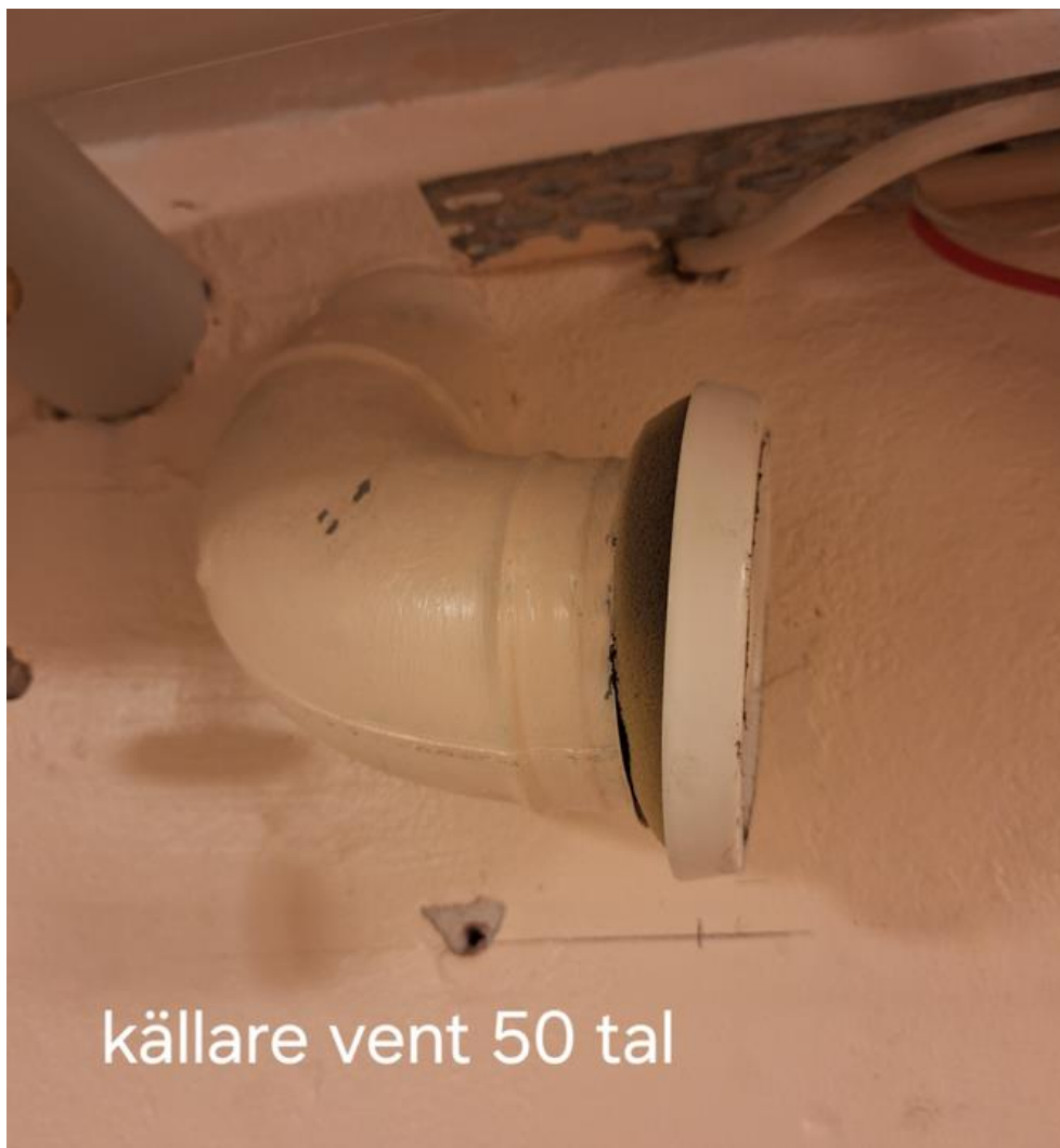
Figur 11 Synlig del av äldre ventilation av plåtrör i källare. Inga synliga tätningsmassor. Ingen misstanke om asbest.
