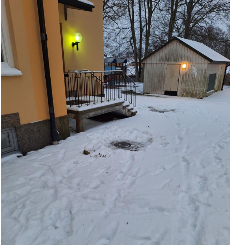
Figur 18 Avloppsbrunn utomhus vid sydvästra hörnet.
