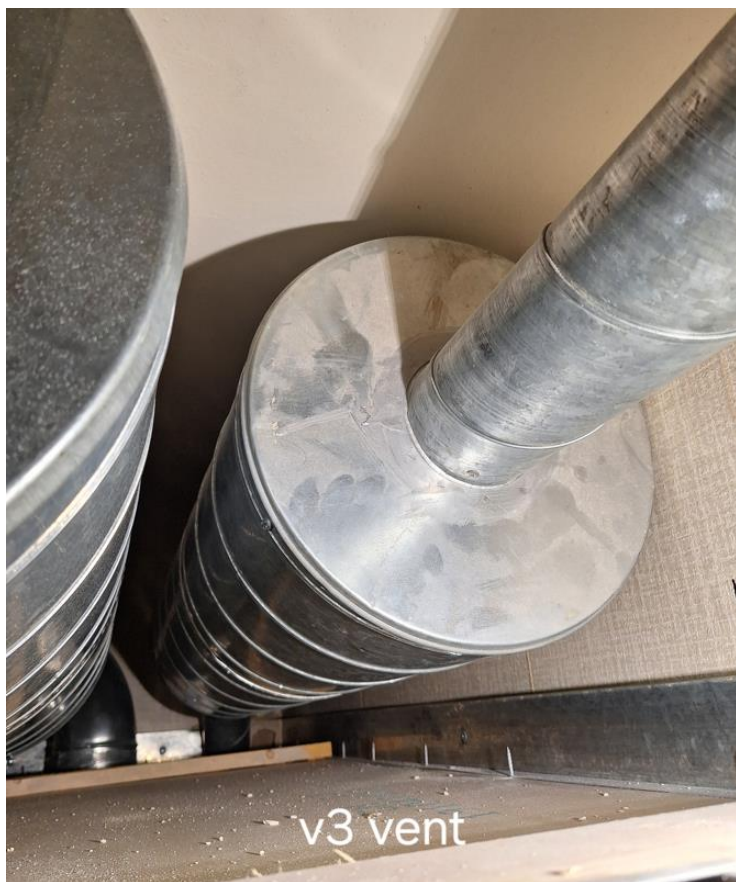
Figur 8 Ventilation, spirorör, 1990-tal, våning 3.
