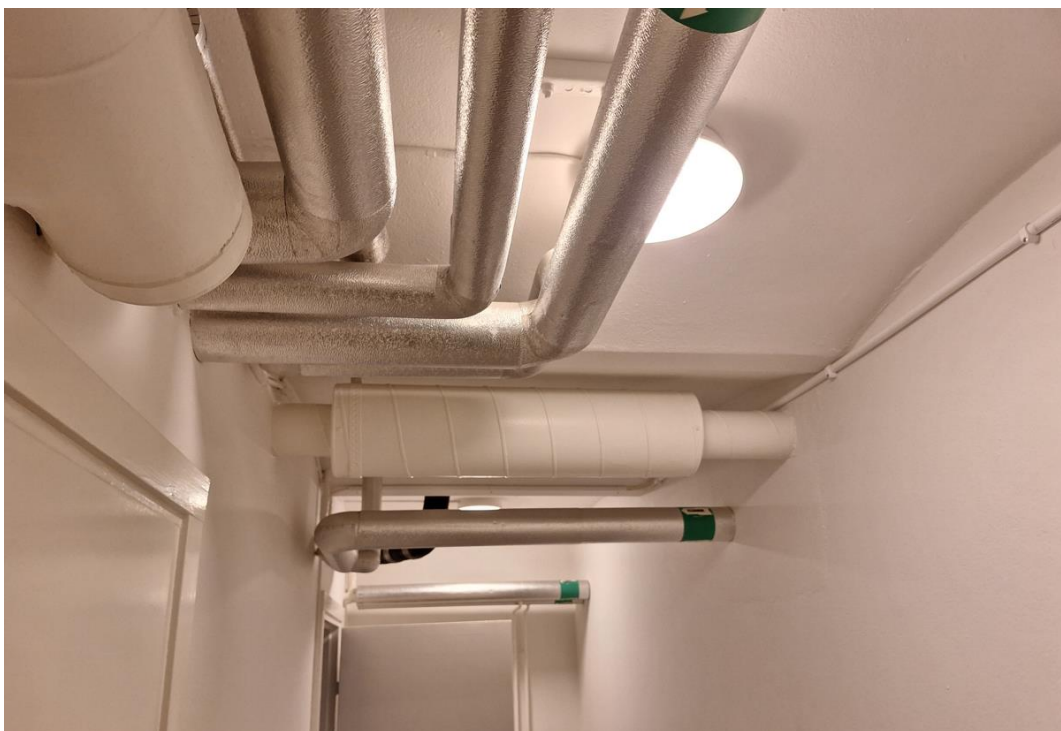
Figur 7 Rörisolering täckt av plast eller aluminiumfolie med inre isolering av mineralull. Ventilation av spirorör eller annat plåtmaterial. Ingen asbest förekommer.
