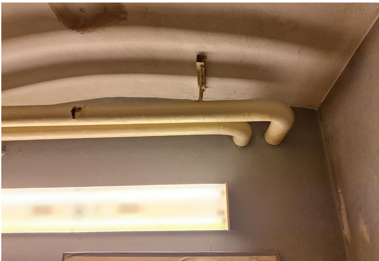
Figur 6 Rörisolering troligen från 1950-tal finns kvar i den södra delen av källare. Asbestförande material finns i yttre armering i böjarna. Raksträckorna är fria från asbest.
