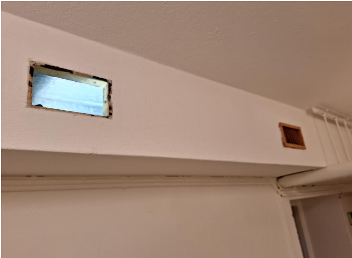
Figur 9 Äldre ventilation, 1950-tal, i källare. Ventiler av trä och invändig fyrkantig galvad plåt.
