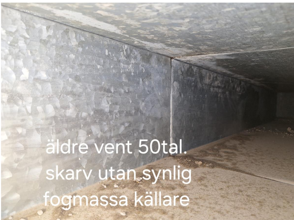
Figur 10 Äldre ventilation, 1950-tal, i källare. Invändig fyrkantig galvad plåt. Skarvarna är inte tätade med fogmassa. Plåtlådornas skarvar är inte åtkomliga för inspektion på utsidan. Det bedöms att de är asbestfria eftersom inga tätningsmassor är synliga inifrån.
