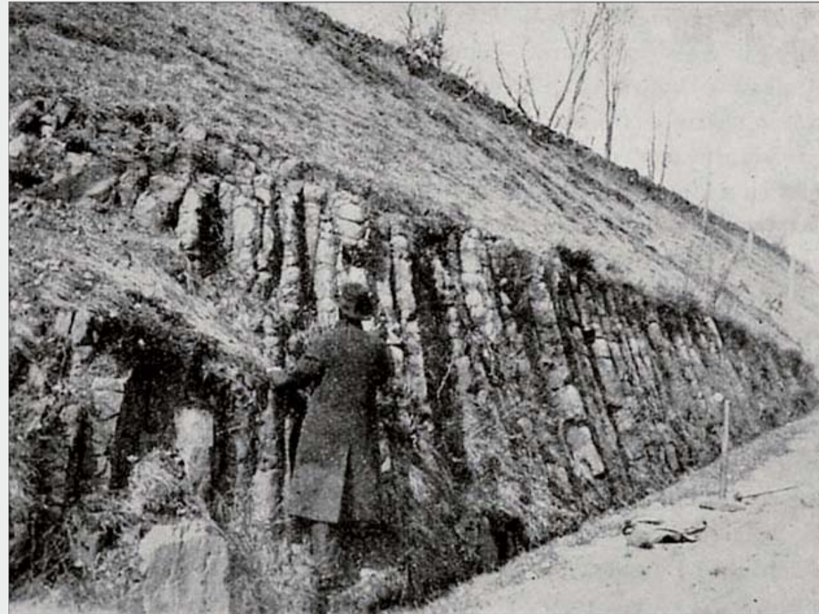
Pelarna vid östra sidan av backen syns tydligt på bilden. De kom i dagen när järnvägen fick dubbelspår vid 1900-talets början.
